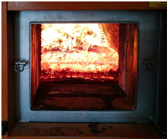
Moderne Holz-Feuerungsanlagen: Dank High-Tech sauber und umweltfreundlich – wenn richtig eingestellt und betrieben.
